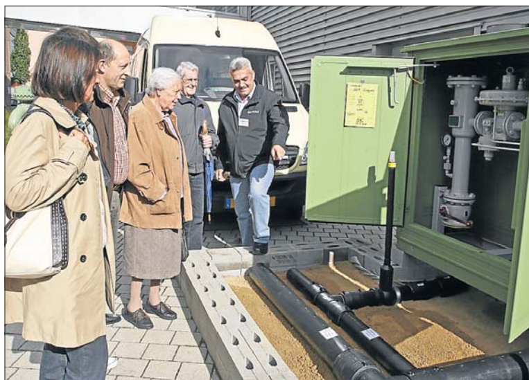
„Sudgaz“-Mitarbeiter Daniel Hager (rechts) erklärt anhand der Reglerstationen, wo das Erdgas mit Hochdruck hereinkommt und mit Niederdruck weitergeleitet wird. (FOTO: LUCIEN WOLFF)
